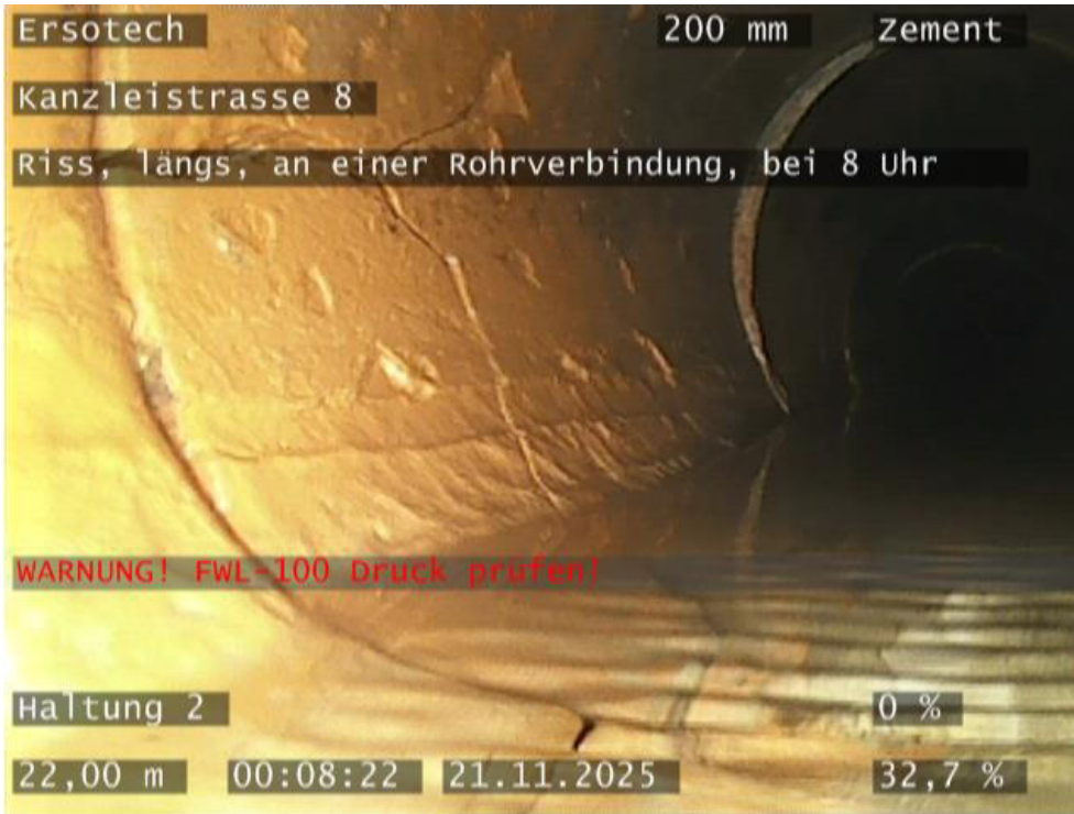
Foto: #21 Entfernung: 22,00 m Kürzel: BABBA Riss, längs, an einer Rohrverbindung, bei 8 Uhr
