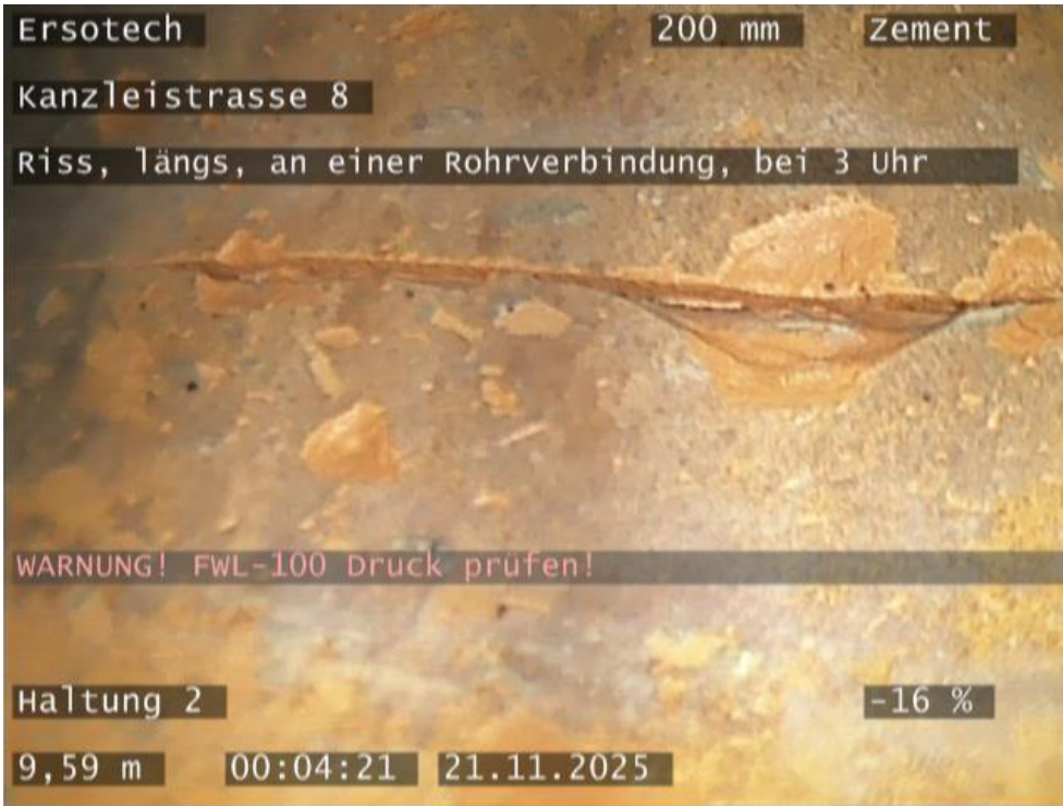
Foto: #11 Entfernung: 9,59 m Kürzel: BABBA Riss, längs, an einer Rohrverbindung, bei 3 Uhr
