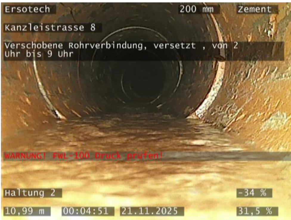
Foto: #12 Entfernung: 10,99 m Kürzel: BAJB Verschobene Rohrverbindung, versetzt, von 2 Uhr bis 9 Uhr
