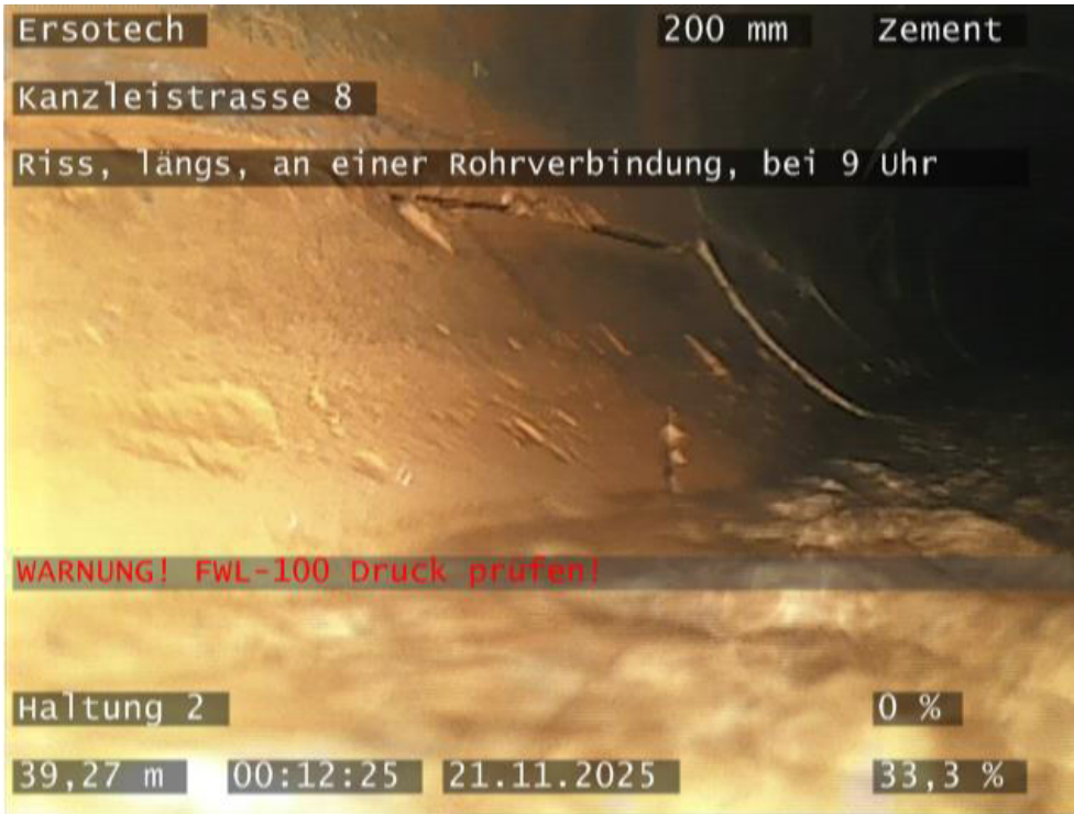
Foto: #27 Entfernung: 39,27 m Kürzel: BABBA Riss, längs, an einer Rohrverbindung, bei 9 Uhr
