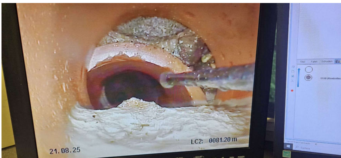
Rohrversatz bei 81.20m, Kamera kann nicht weiter
